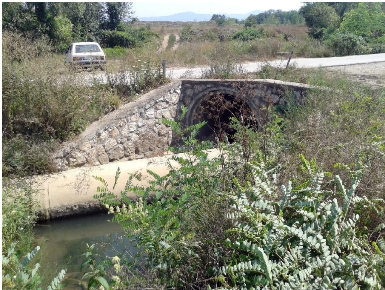
Слика 11. Атеничка река ID:RPMAt1 (Канализациони колектор који се налази у кориту водотока, заједно са пропустом недовољног пречника. Најнизоводнији пропуст)
