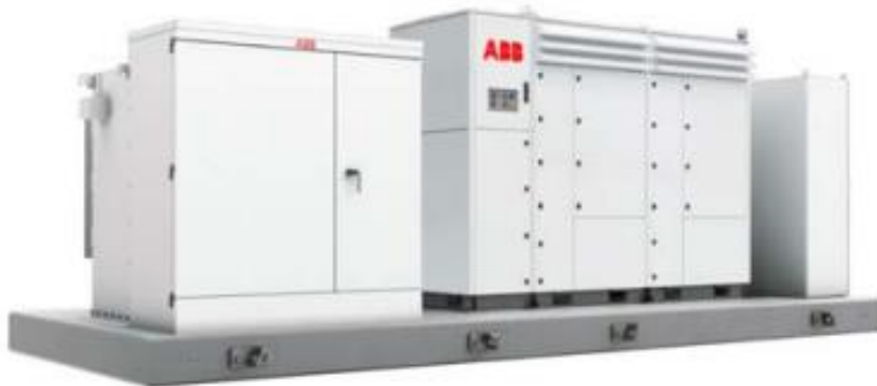
Слика број 14- Типични изглед инверторске станице
