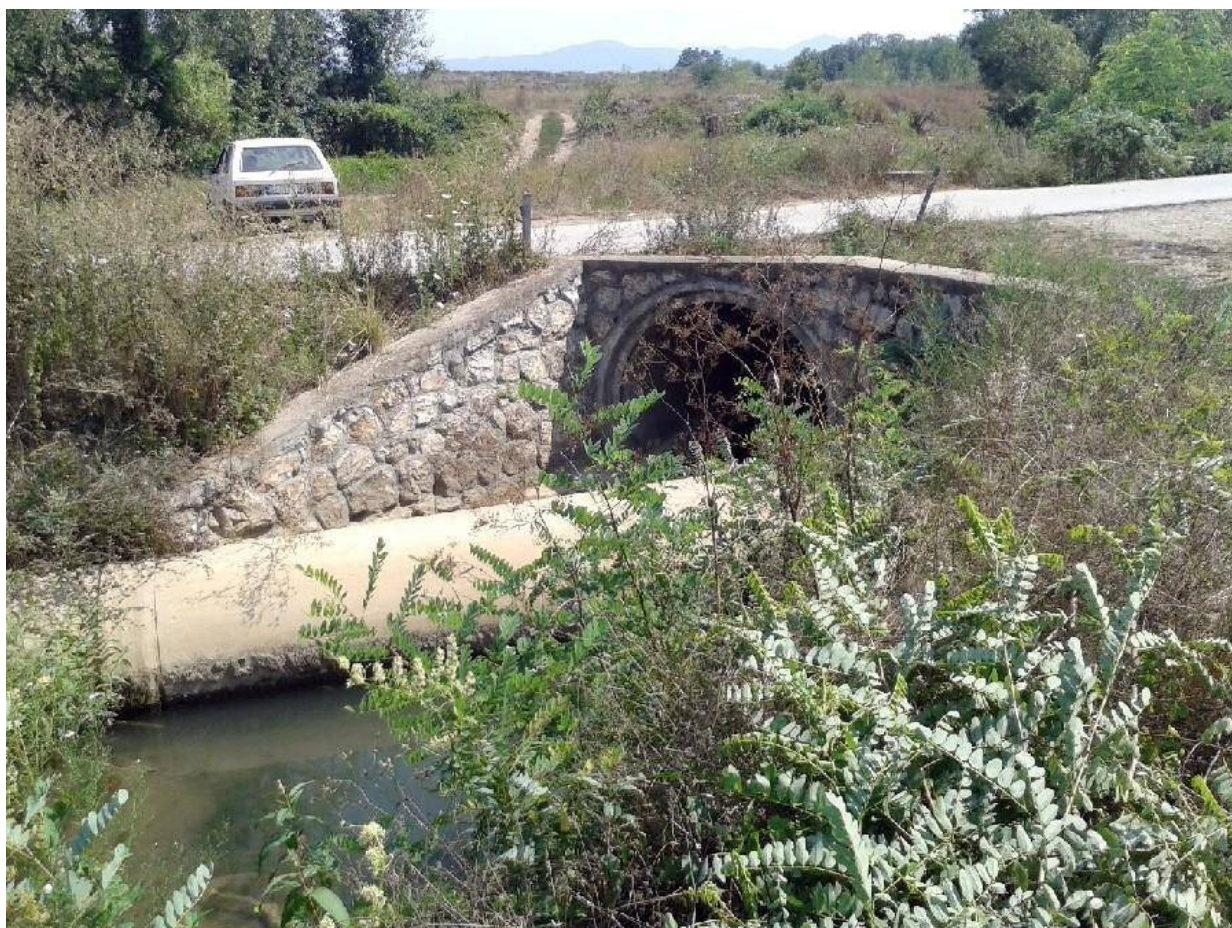
Слика 11. Атеничка река ID:RPMAt1 (Канализациони колектор који се налази у кориту водотока, заједно са пропустом недовољног пречника. Најнизовнији пропуст)
