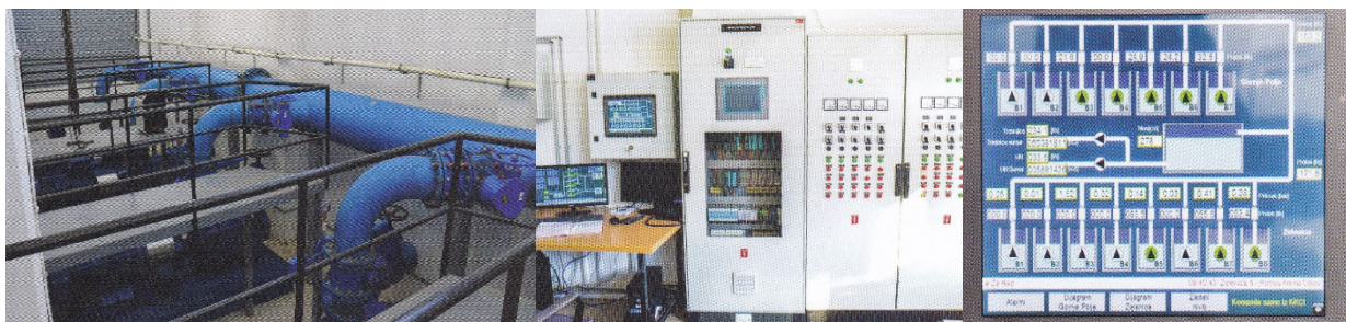
Слика бр. 17: Систем за праћење квалитета питке воде
