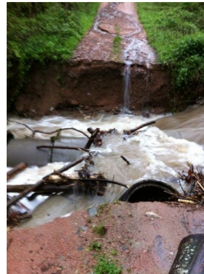
Урушен пропуст на Селачкој реци
